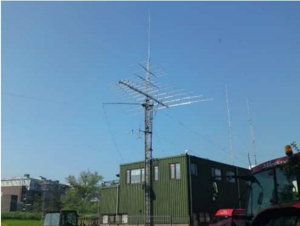
Vrijstaande antenne-installatie op bedrijventerrein
